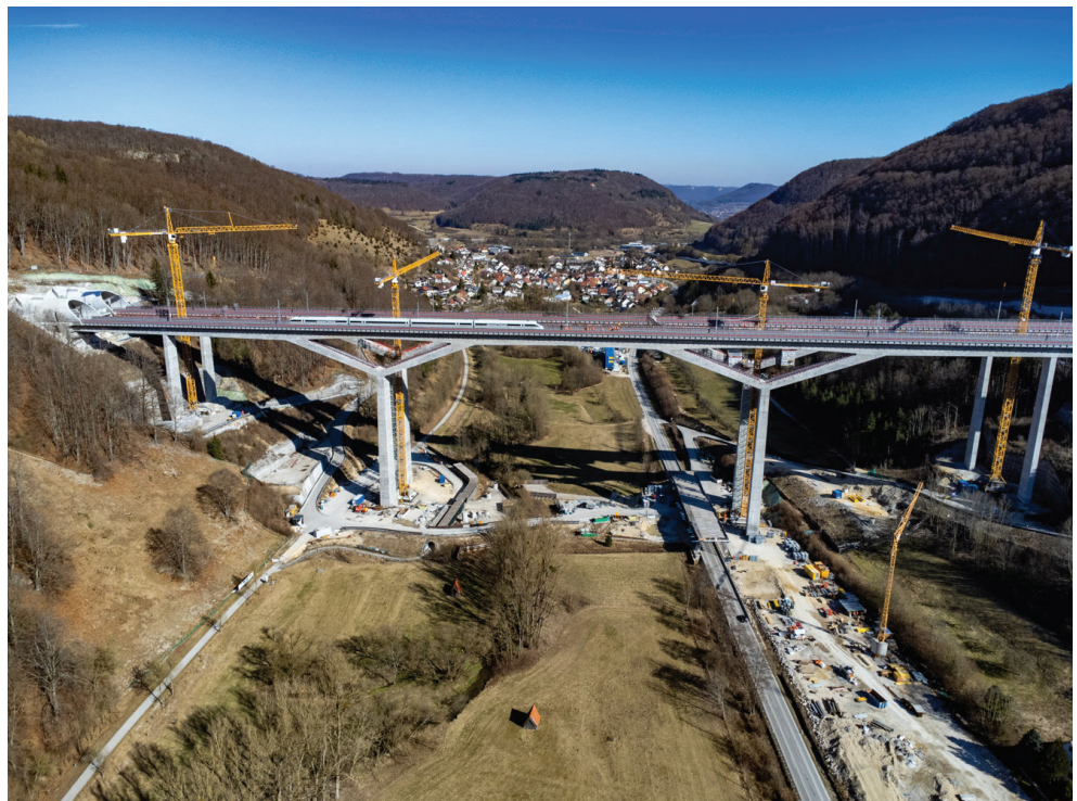
Die Doppelbrücke über das Filstal in Süddeutschland ist Teil des Abschnitts Stuttgart-Ulm der europäischen Hochgeschwindigkeits-Bahnstrecke zwischen Paris, München, Wien, Bratislava und Budapest.
